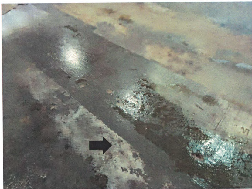
Figura 8 - contrapiso com umidade
