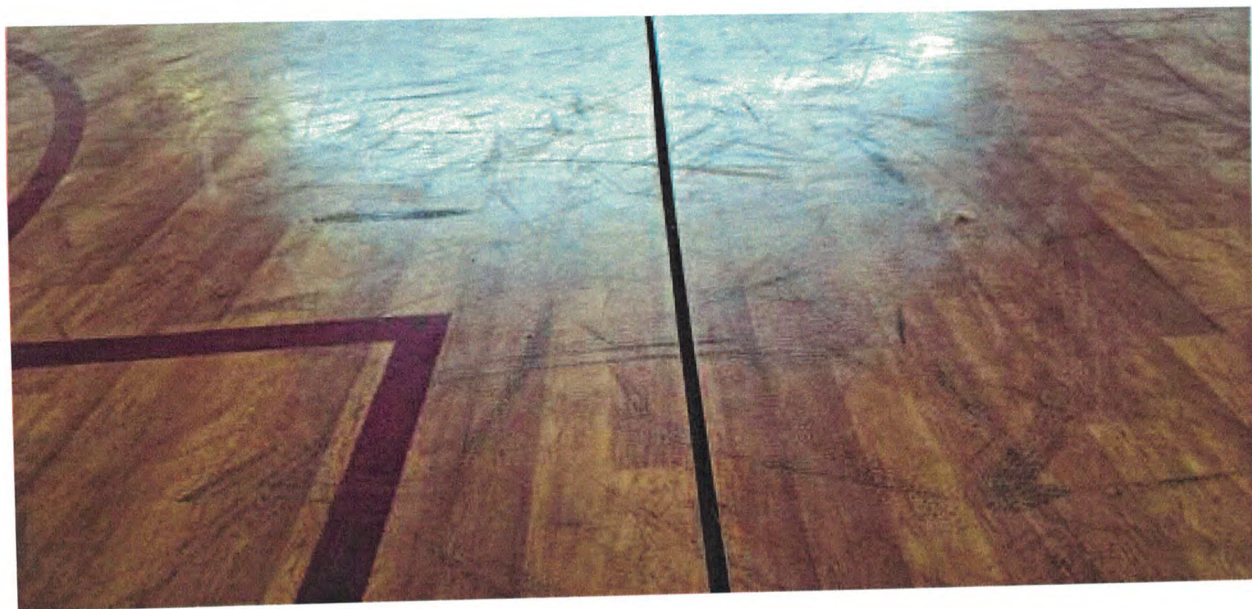
FOTO 05 - Situação atual do piso vinifico
