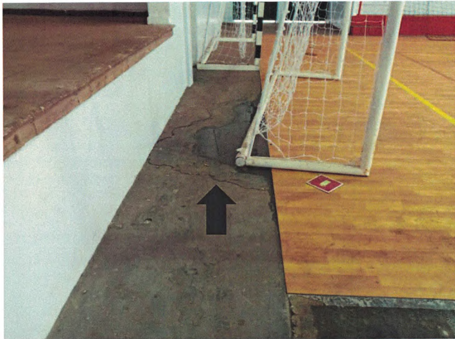
Figura 2 - demonstrativo de umidade na quadra
