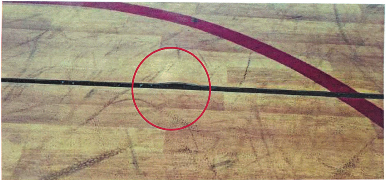
FOTO 07 - Situação atual do piso vinifico
