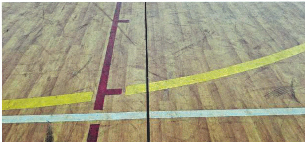
FOTO 04 - Situação atual do piso vinifico
