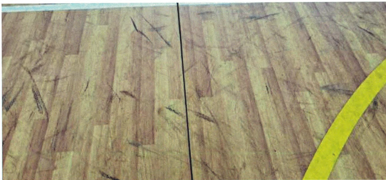
FOTO 02 - Situação atual do piso vinifico
