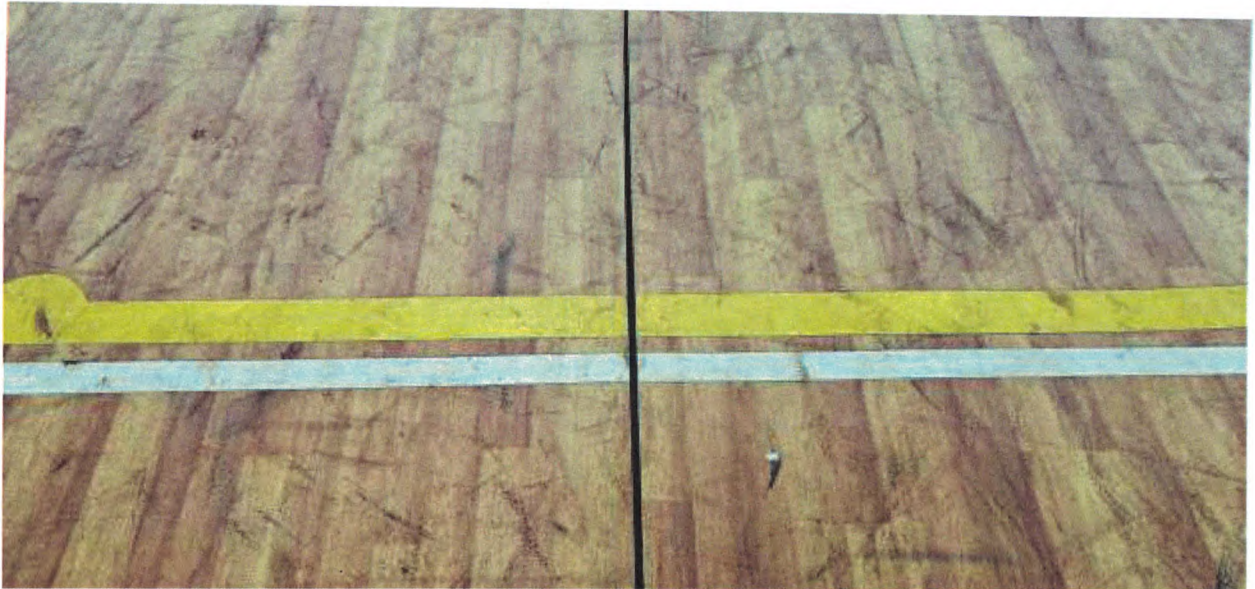
FOTO 09 - Situação atual do piso vinifico
