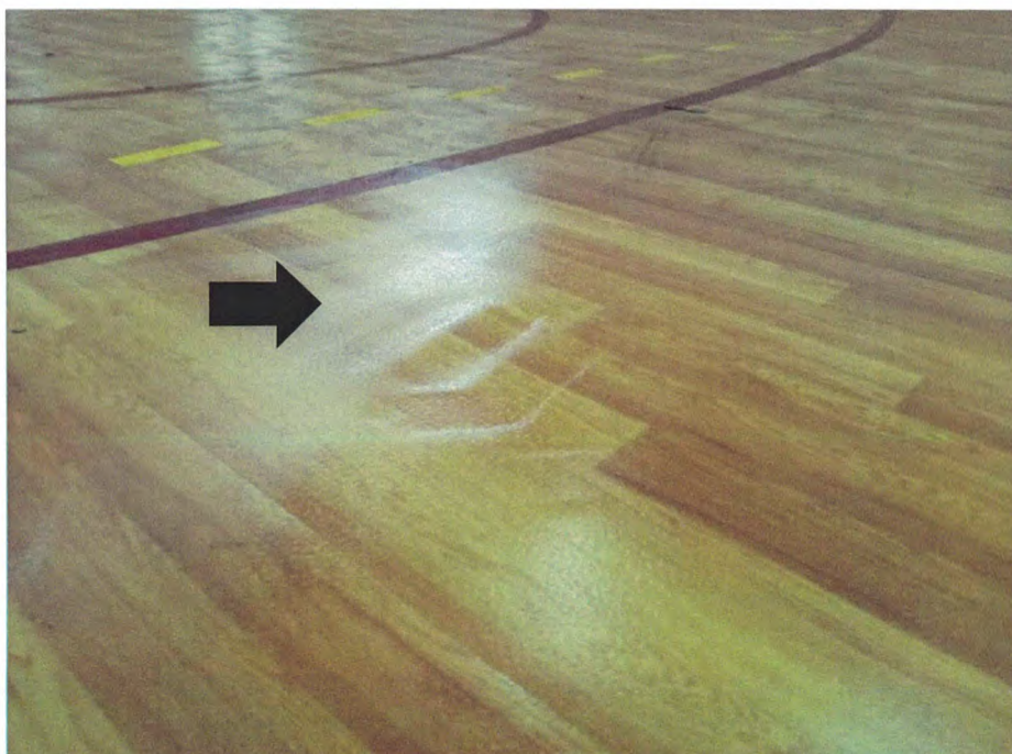
Figura 5 - piso marcado por carga pontual não protegido conforme recomendação
