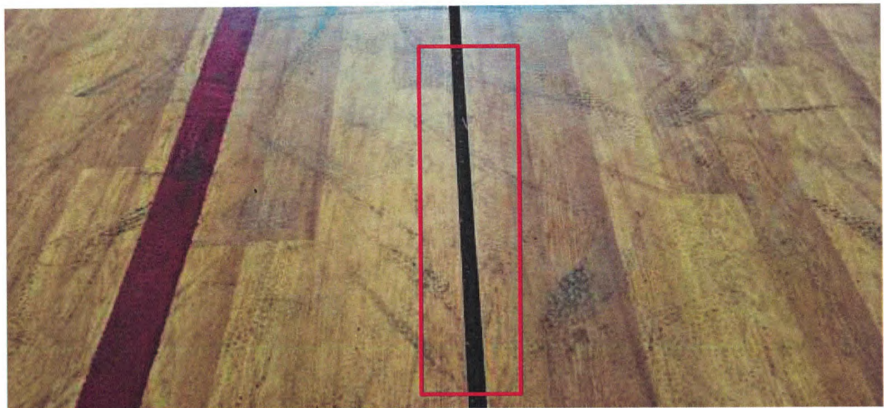
FOTO 08 - Situação atual do piso vinifico
