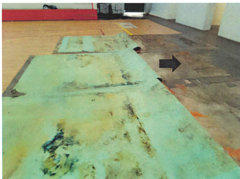
Figura 7 - mantas e pisos com umidade
