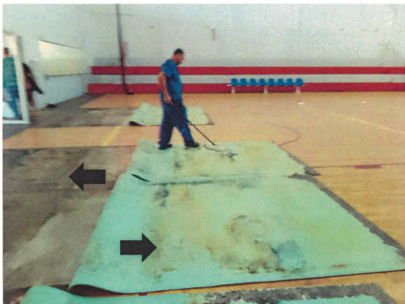
Figura 6 - problema de infiltração contínua
