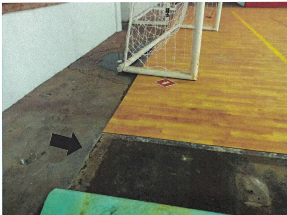
Figura 3 - situação das mantas e piso com umidade
