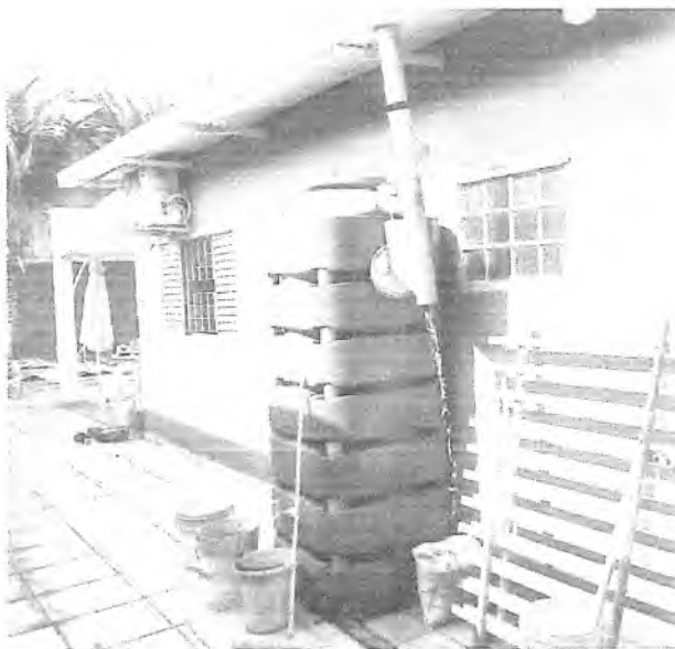
Imagem 01. Sistema de captação de água da chuva (alínea “a”, Art.3º).
