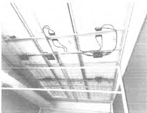
Imagem 04. Sistema de aquecimento elétrico solar (alínea “d”, Art. 3º).
