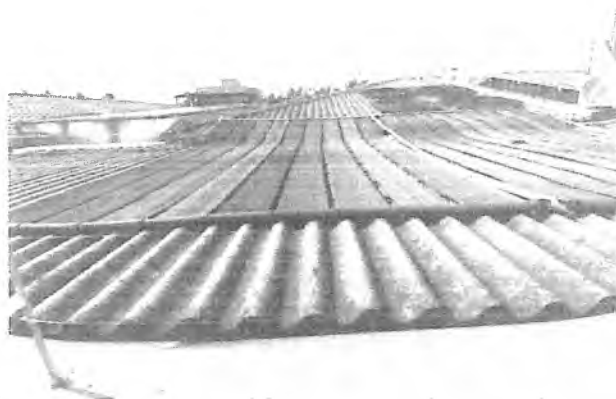
Imagem 03. Sistema de aquecimento hidráulico solar (alínea “c”, Art.3º).
