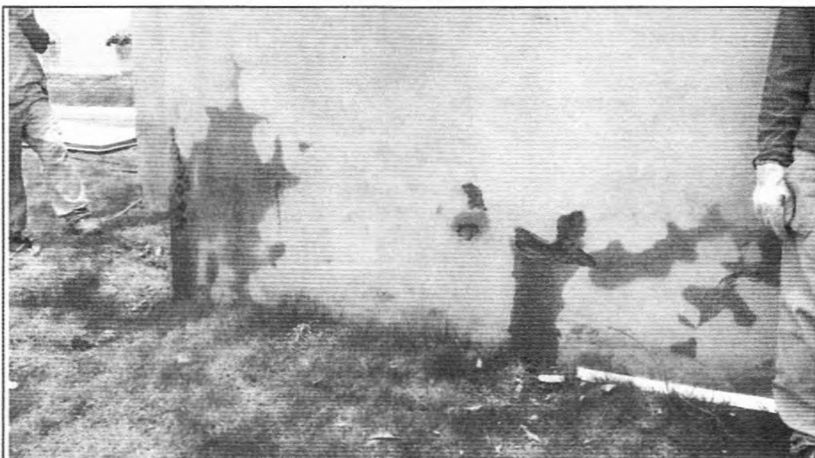
Descrição: Vazamentos na parede da Caixa de Fluxo 2.
