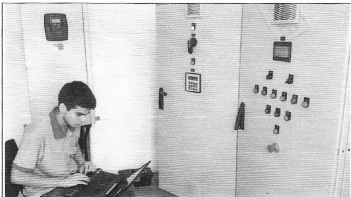
Descrição: Funcionário da Integratec realizando configuração da Casa de Painel 1. Foto: 16 Data: 22/01/15 Arquivo: 134744
