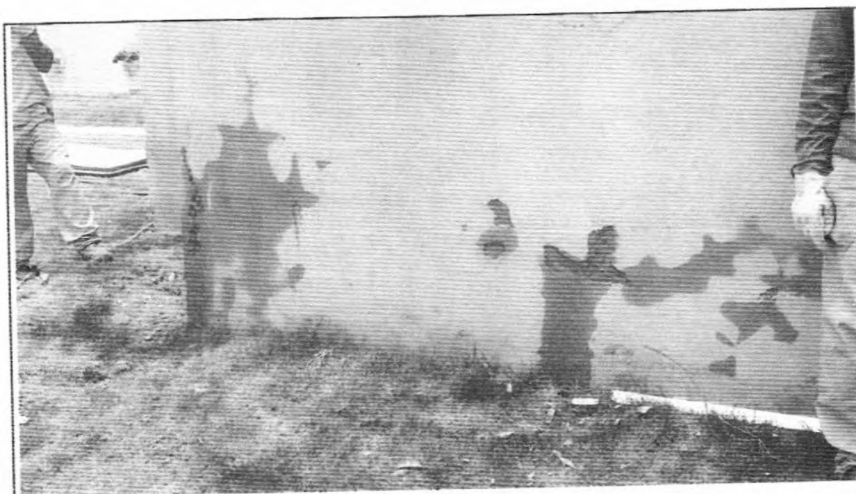
Descrição: Vazamentos na parede da Caixa de Fluxo 2.
